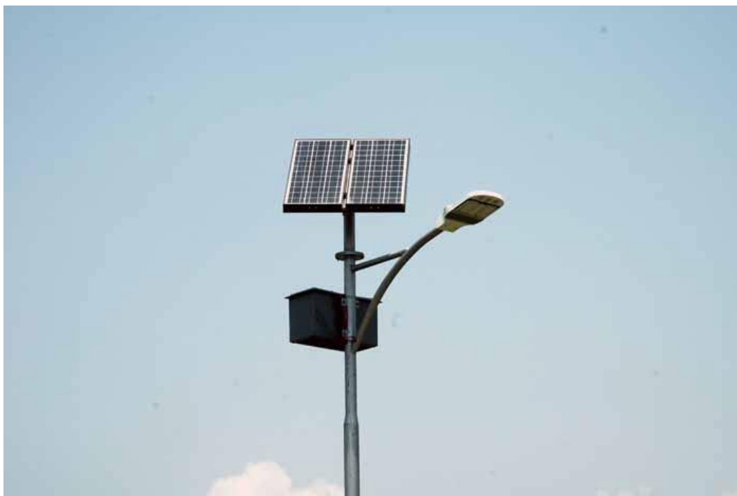
Εικόνα 15: Φωτοβολταϊκό πλαίσιο σε πυλώνα φωτισμού
